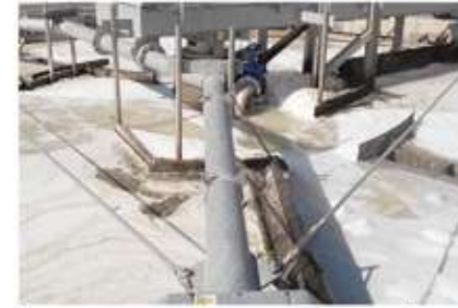
05 پمپ SVP در سیستم DAF
